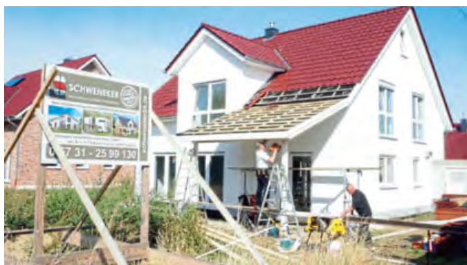
In der Hüllstraße: Hier entsteht ein attraktives Einfamilienhaus in Satteldacharchitektur mit zwei Zwerchgiebeln. FOTOS: STEPHAN PFEIFFER
